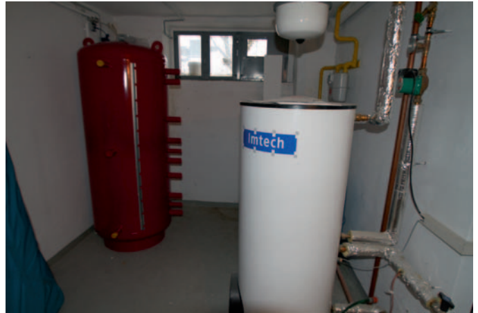
Neuer Pufferspeicher (rot, in der Ecke) im Heizungskeller
